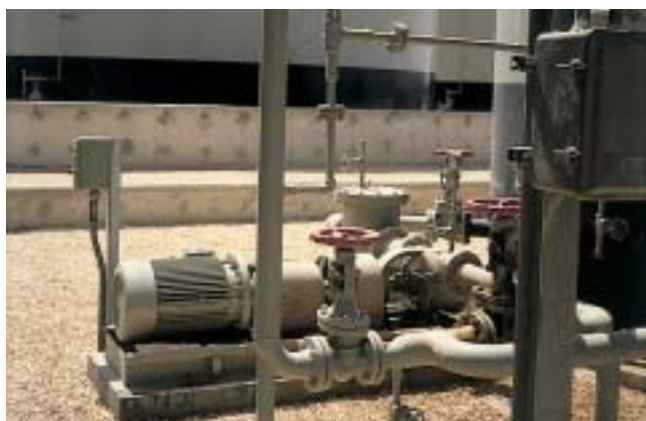
V100-2 ST4W pump in a lubricating oil plant. Pompe V100-2 ST4W dans un équipement d'huile lubrifiante.
